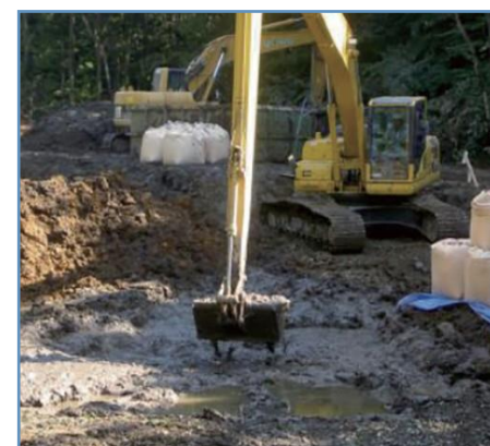
蓄水池沉积泥浆
